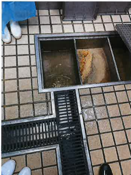
排水溝通暢並設有截油槽截流設備
