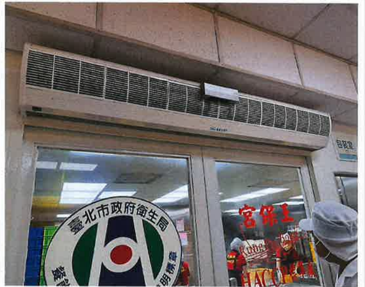
出入口設置空氣簾防止病媒蚊、蒼蠅、小飛蟲進入
