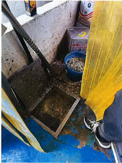
水溝截流槽食物殘渣未整理，雖有一道門隔開，但仍需改善，以防止鼠害。
